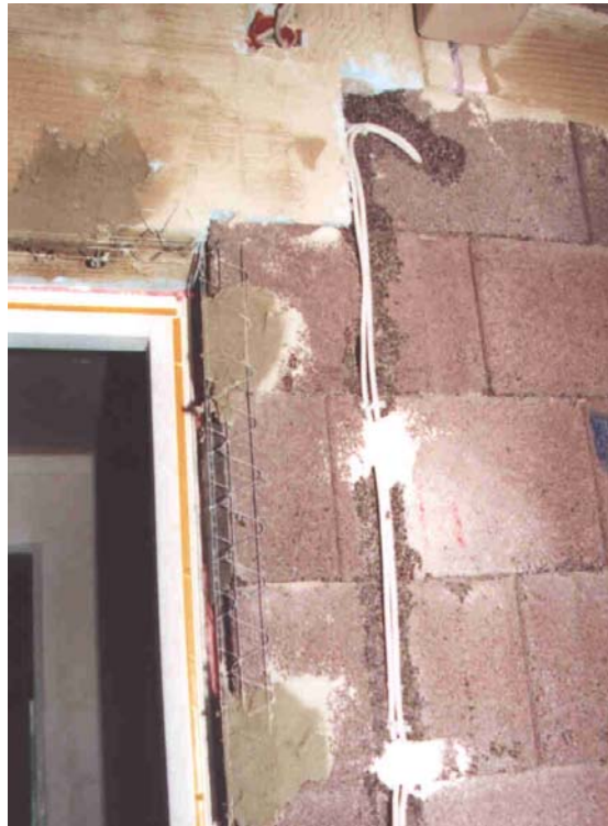
Abb. 4: Beispiel „Mangel am eigenen Gewerk“: Ungenügende Vorbehandlung der Wärmebrückendämmung und Belassen der Gipsplomben führt zu Schäden an der Putzfassade (Hohlstellen, Risse)
